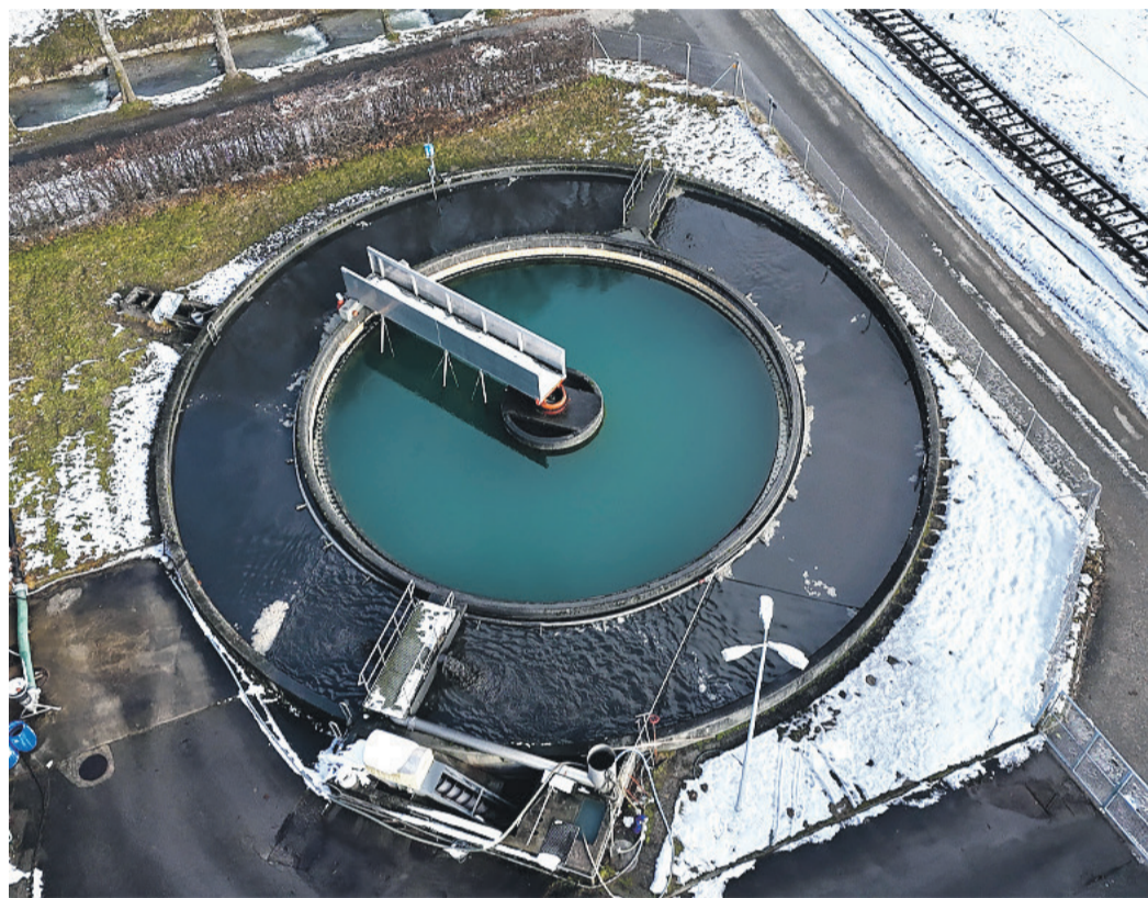
SIH. La station d'épuration sera au centre du projet de la commune d'Henniez pour exploiter ses sources d'énergie locales.
